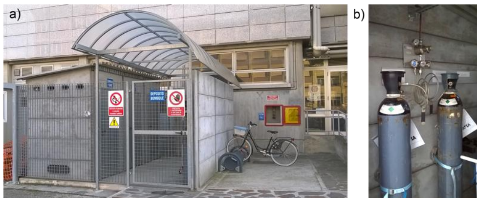
Figura 3: Bombolaio esterno del laboratorio LITHO: a) porta d'accesso al bombolaio, presso l'ingresso fornitori dell'edificio Fisica; b) rampe di collegamento delle bombole di azoto per la linea di distribuzione del laboratorio LITHO, presso il box n. 3.
