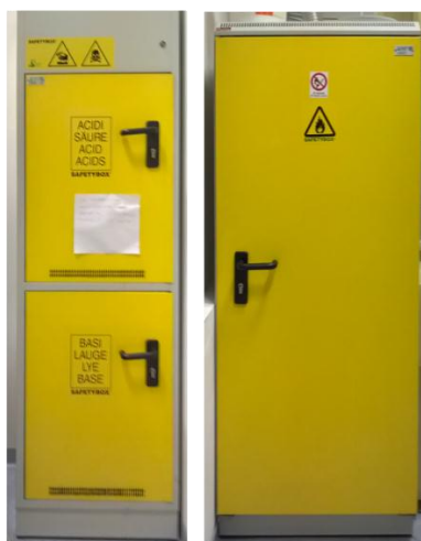
Figura 13: Armadi di sicurezza ventilati collocati presso il laboratorio LITHO.
