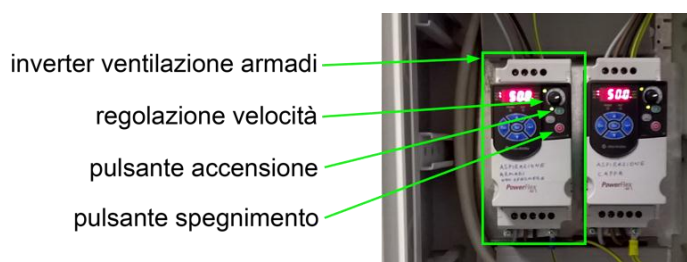
Figura 12: Quadro elettrico per la regolazione degli inverter di aspirazione della cappa e degli armadi di sicurezza.
