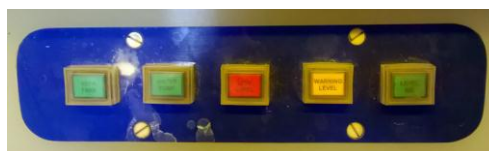
Figura 15: Quadro elettrico di controllo del sistema di erogazione acqua ultrapura.
