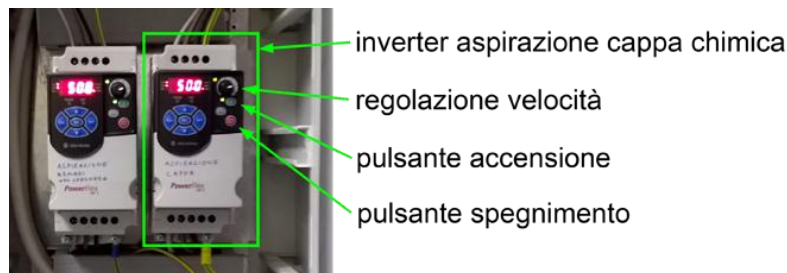
Figura 8: Quadro elettrico per la regolazione degli inverter di aspirazione della cappa e degli armadi di sicurezza.
