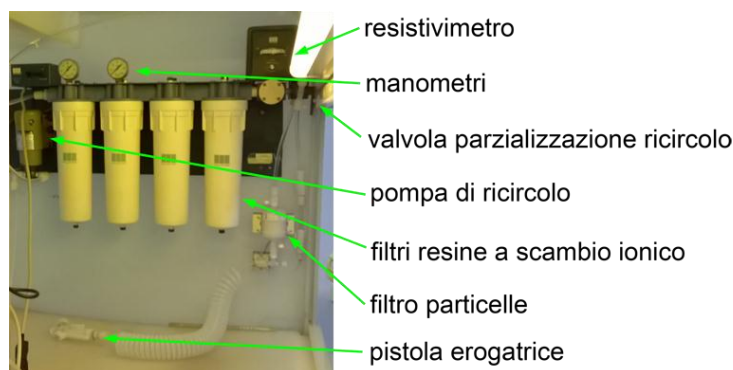
Figura 14: Impianto di purificazione, circolazione ed erogazione dell'acqua ultrapura.
